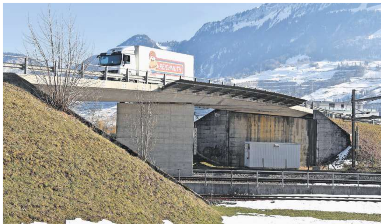
Die Tage des bisherigen Viadukts im 17-ni in Ingenbohl sind gezählt, er reicht für die künftige Erschliessung von Brunnen Nord bei Weitem nicht aus und muss ersetzt oder massiv ausgebaut werden. Bild: Josias Clavadetscher
